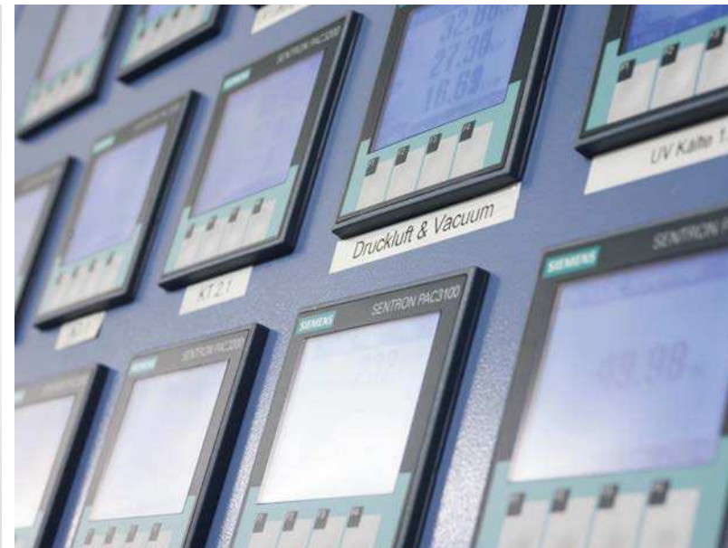
Urządzenia pomiarowe 7KM PAC z funkcją komunikacji dostarczają dane o stanie sieci
