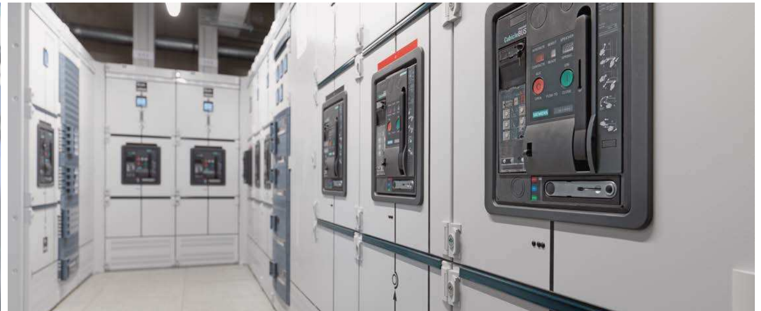
80 rozdzielnic niskiego napięcia SIVACON S8 zapewnia bezpieczną dystrybucję mocy
